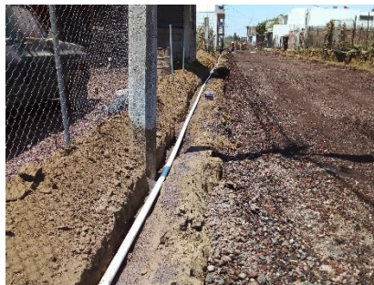
Red de agua calle Magisterial
